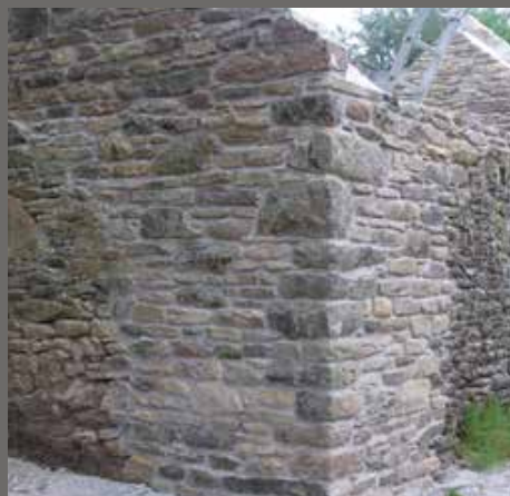
Sur ce mur, les joints, trop épais, ne s'intègrent pas dans l'existant.
